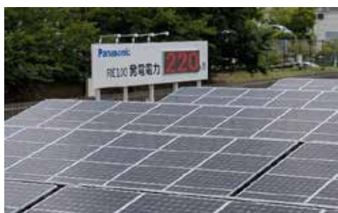
【太陽光パネルと発電量表示】
