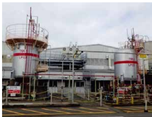
< 高圧ガス施設 >
