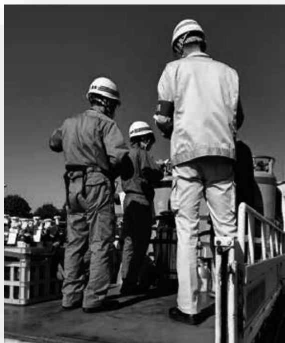
【ポンベの固定状況を確認する担当者】
