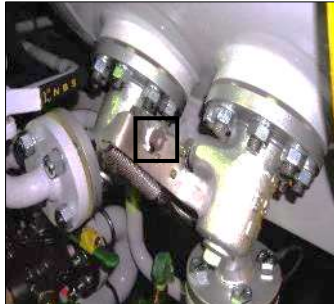
緊急遮断弁のヒューズメタル
