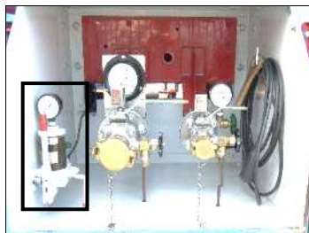
油圧式緊急遮断弁
