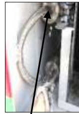
フレキシブルチューブ及びフランジとの接続部
