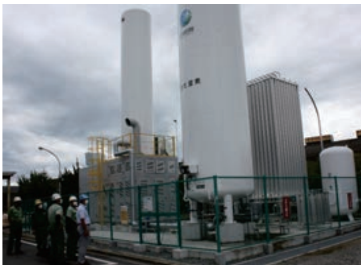
【高圧ガス窒素製造消費施設と説明を受ける筆者ら】
