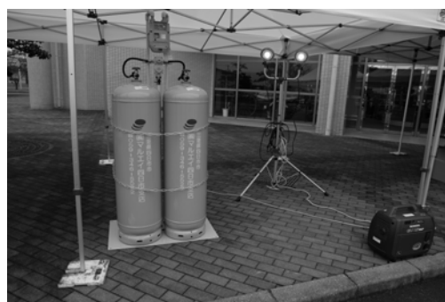
L P ガス発電機
